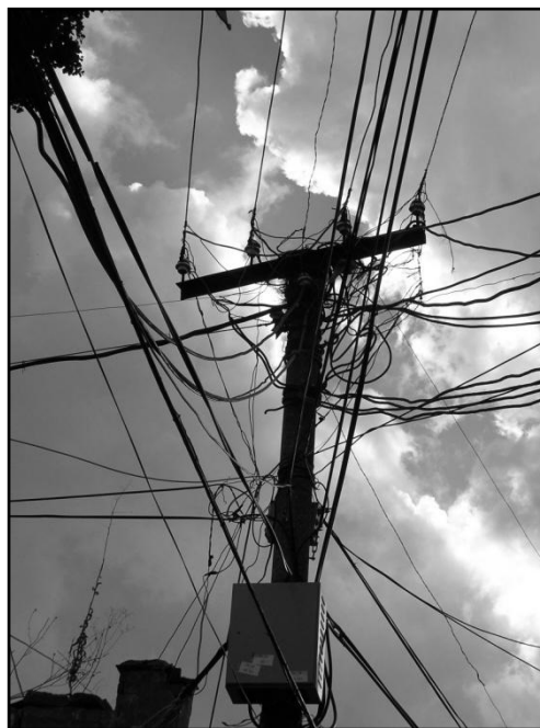
svěrázný způsob rozvodu elektřiny
